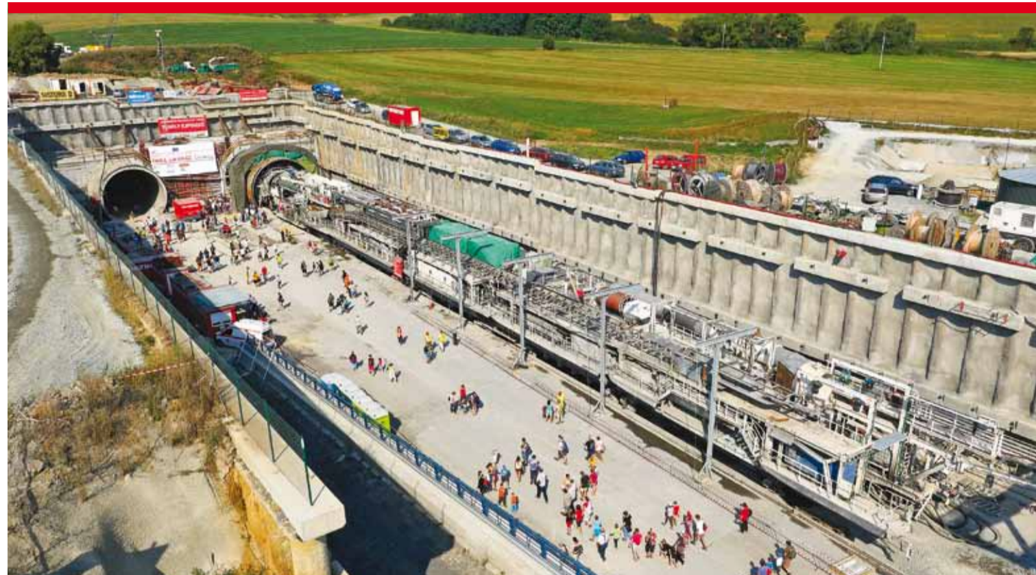
S-799 – razicí stroj konvertibilní EPB/Hardrock pojmenovaný Viktorie čeká ve vjezdovém portálu v Kyšicích na druhý start pod vrchy Homolka a Chlum. Průměr štítu 9,85 m, délka stroje 114 m, váha 1800 t, maximální tlačná síla 73 890 kN. Hotovo: jižní tubus tunelů Ejovice o délce 4020 m. Zbývá vyrazit: o 30 m delší tubus severní. Více na straně 4.
